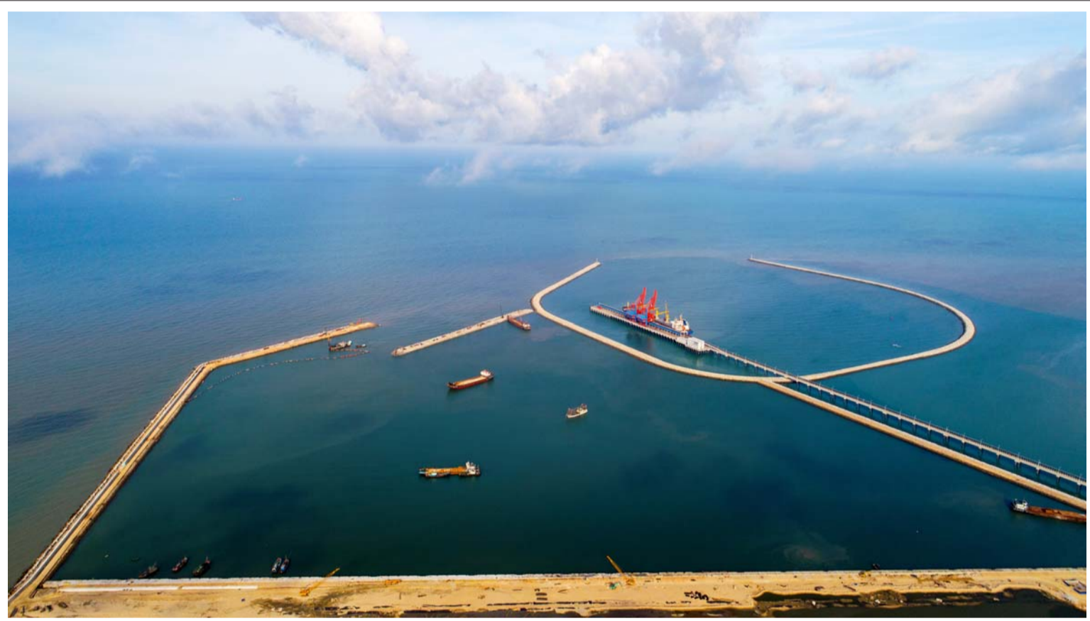
8月31日，五公司承建的莺歌海渔业加工区及配套码头主体工程顺利完工。该工程属于国家一级渔港，由码头、防波堤、护岸、港池疏浚、临时围堰五部分组成。码头主体的顺利完工，结束了当地渔民300多年无渔港的历史。
