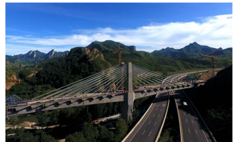
近日，城交公司承建的京沈客专跨承德高速大桥塔斜拉T构合龙。该桥全长315米，斜拉索采用扇形布置，共设18对。T构上跨承德高速，为高空作业，安全风险高、技术要求高、施工工艺复杂。
