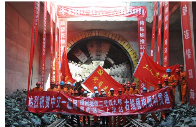
9月5日，城交公司承建的福州地铁二号线第九标段前屿站至上洋站右线盾构区间顺利贯通。该盾构区间掘进全长1212米，隧道直径6.45米，管片用量1003环。
