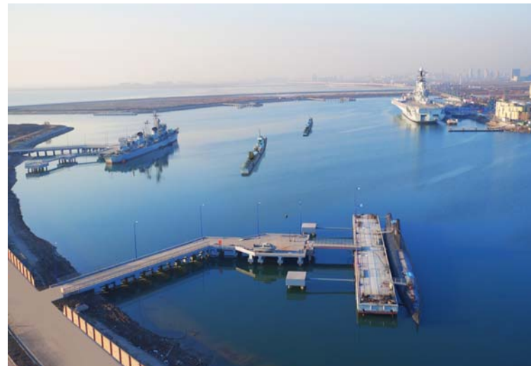
近日,一公司第十项目部承建的天津滨海航母主题公园航母编队、舰艇落位旅游基础设施建设项目完工,该项目以现有“基辅号”航母为中心,包括新建4个特定舰艇泊位和1个游船泊位。赵润宇 摄影报道
