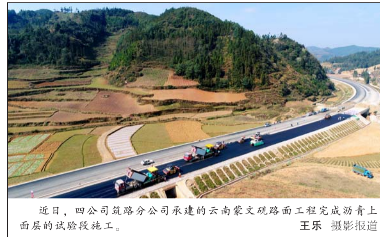
近日，四公司筑路分公司承建的云南蒙文砚路面工程完成沥青上面层的试验段施工。 王乐 摄影报道
