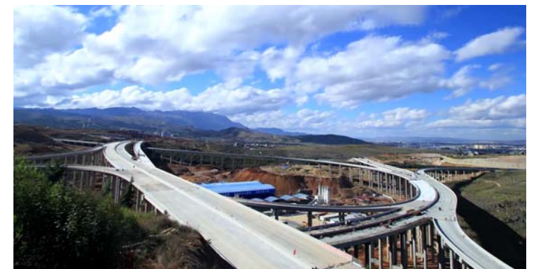
近日，一公司承建的蒙文砚项目蒙自互通B匝道最后一联桥面铺装浇筑完成，标志着蒙文砚高速公路管段非转体部分所有桥梁工程施工结束
