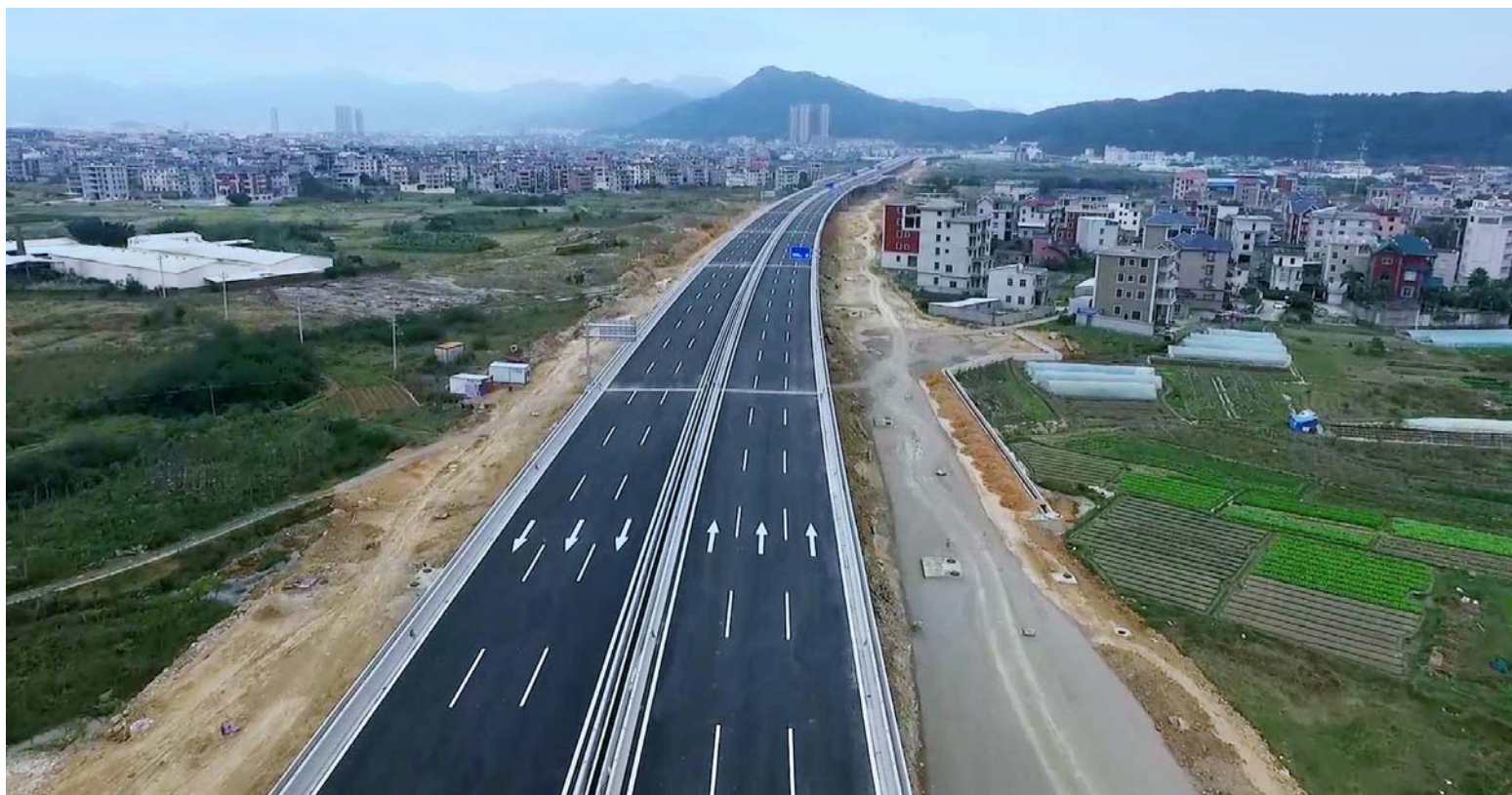
1月23日和25日，一公司、总承包分公司承建的福清市汽车专用线二期道路相继实现主线通车，极大缓解了福清市春运期间交通压力，方便了居民出行。图为—公司福清项目部承建的虎溪—融宽环路段。
